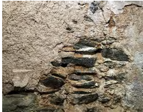
18. Estructura edilicia de la torre (mortero de cal, arena y enfoscado de yeso).
